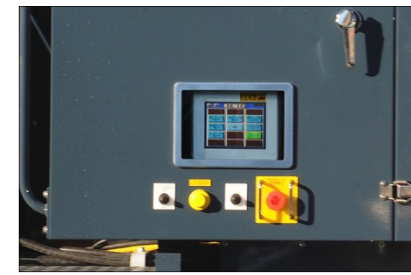
集中表示装置(メンテナンス トラブルシューティング)
