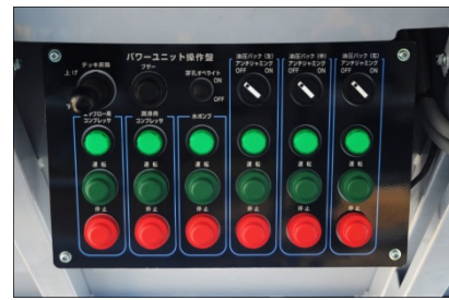
3ブームパワーユニット操作パネル
