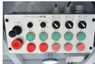
3ブームパワーユニット操作パネル
